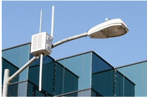
Accespoint in een buitenbehuizing, inclusief meshed interlink verbindingen.
